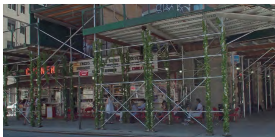
Figura 4. Personalización de los andamios por parte de comerciantes del capítulo de How To with John Wilson . Fuente: How To with John Wilson , Temporada 1, Episodio 2, "Cómo montar un andamio", 2020, en HBO. Disponible en https://www.hbomax.com/es/es/series/urn:hbo:series:GX1pL-A4slcMslAEAAAy (Última consulta noviembre 2023)
