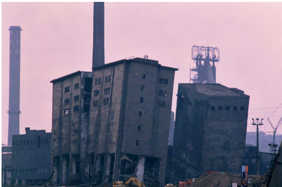
Figura 2. Derribo de Altos Hornos de Vizcaya (AHV) en la zona de Baracaldo, 1995.
